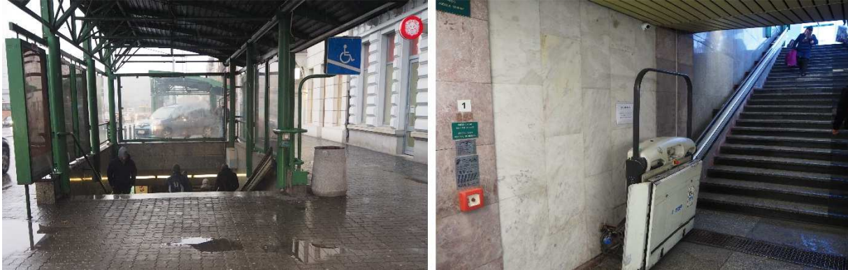
Fot. II.7 Przykład zastosowanej pochylni mechanicznej Źródło: zasoby VIA VISTULA
