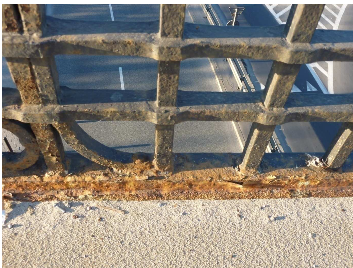
Fot. 11. Uszkodzenia korozyjne balustrady wiaduktu.
