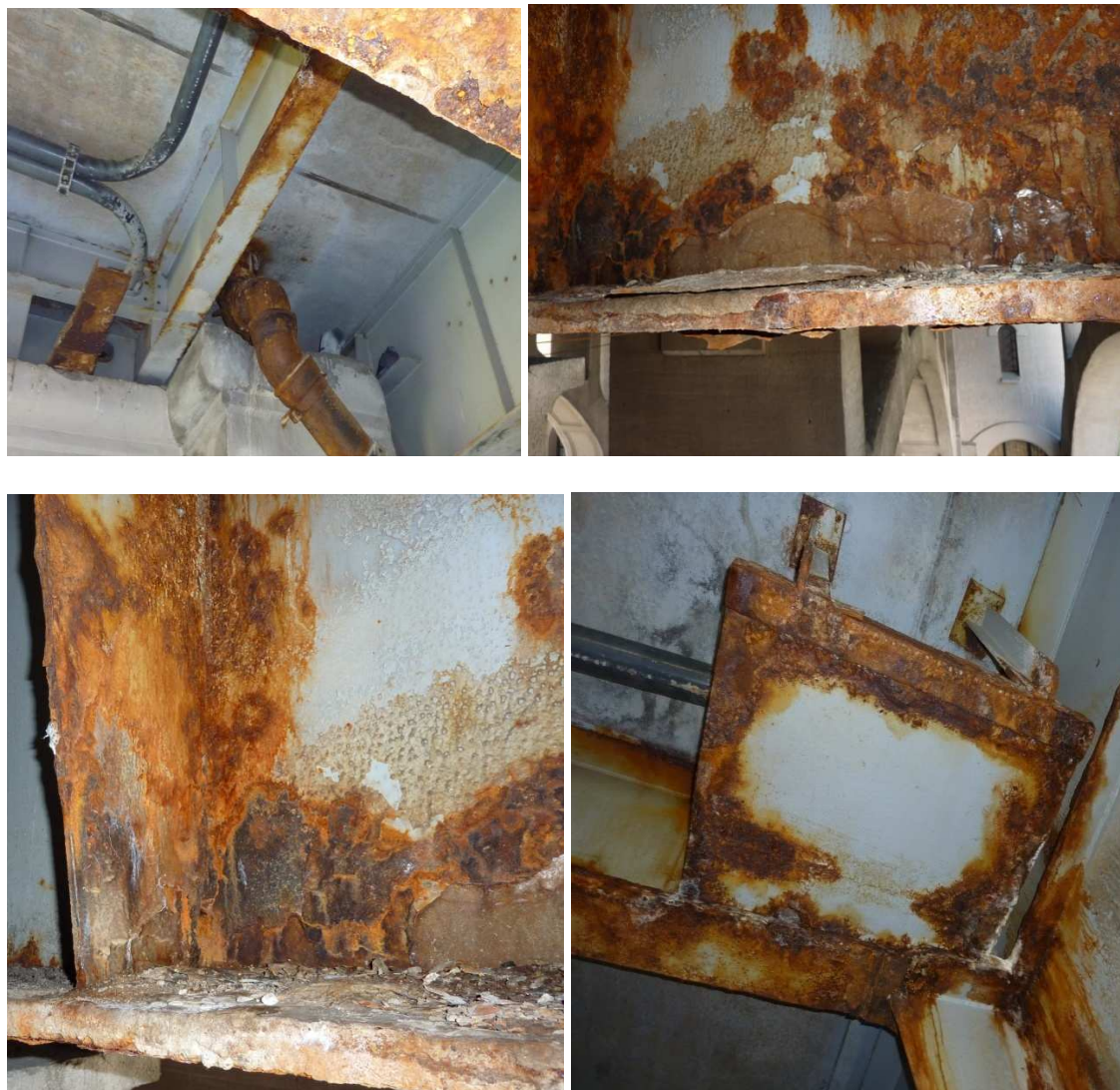
Fot. 12-15. Silnie skorodowane elementy rejonu odwodnień do wymiany lub napraw.
