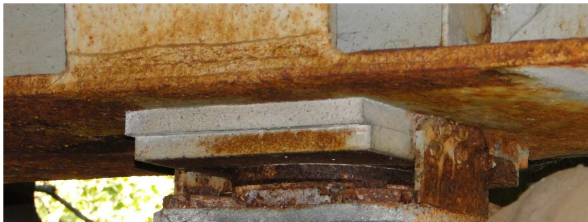
Fot. 16. Skorodowane łożysko
