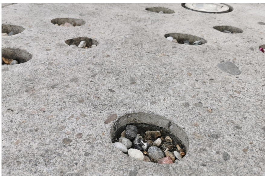
Ilustracja 22. Otwory w posadzce, z których wybrane zostały kamienie stanowią zagrożenie dla osób poruszających się hulajnogami
